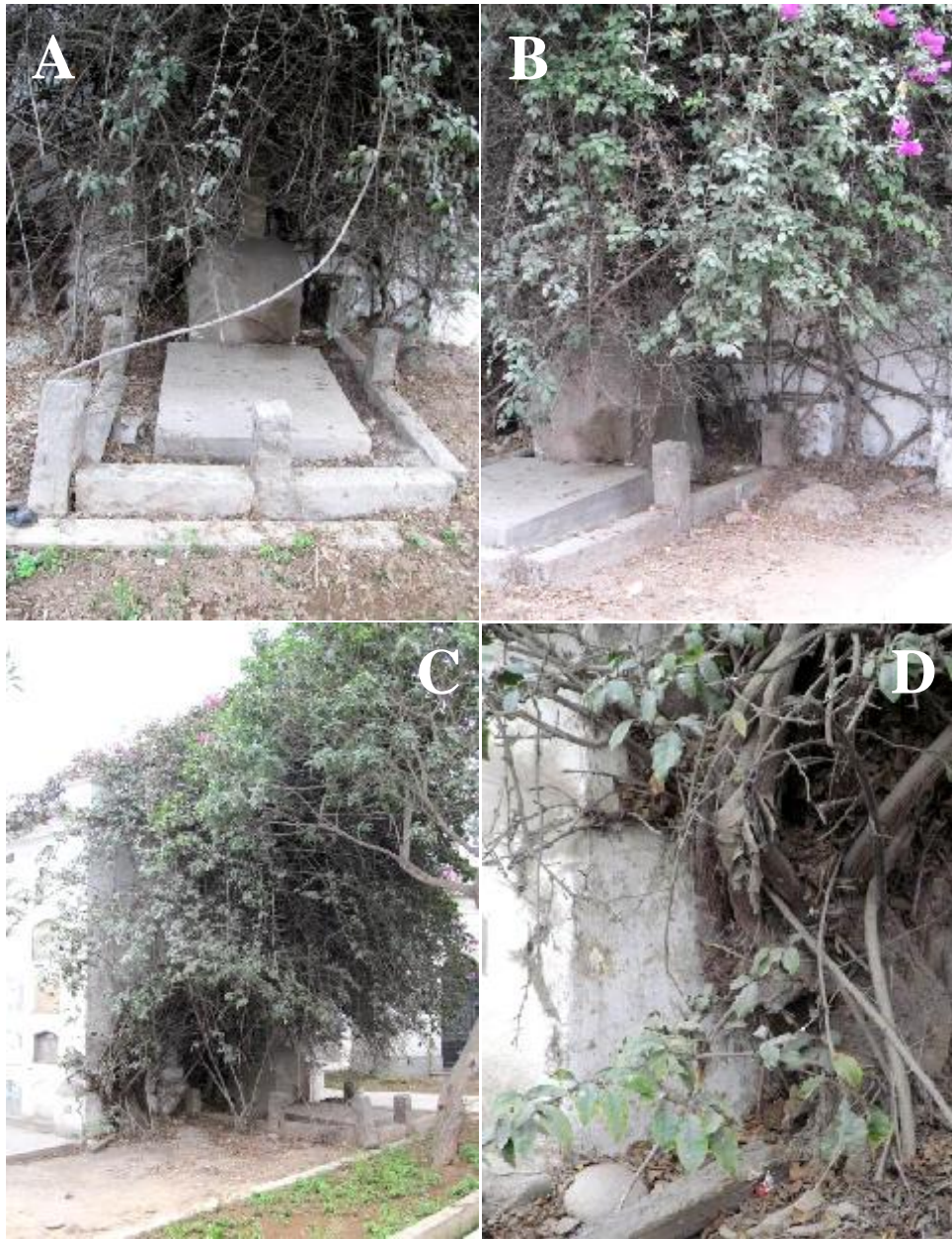
Fig. 7. Boungavillae spp; A y B. utilizando la pared de un cuartel de nichos mortuorio como soporte para su crecimiento; C y D. Engrosamiento del tallo, ejerce presión y daño en la pared.
