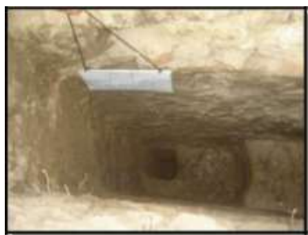
Figura 11. Vista de la Calicata realizada en la Zona IV (Av. América Sur - Trujillo)
